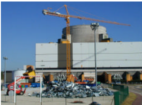
vue sur les aires de découpe et de tri des déchets conventionnels avant évacuation vers filières de recyclage
